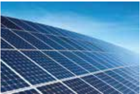
太陽光発電 Photovoltaic
